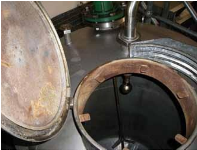
Povrchová koroze - před a po odstranění pomocí Avesta Cleaner 401.
